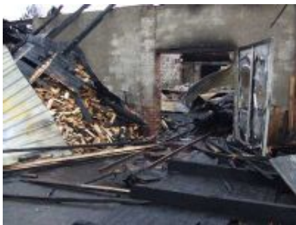
Die Werkhalle liegt in Schutt und Asche.
